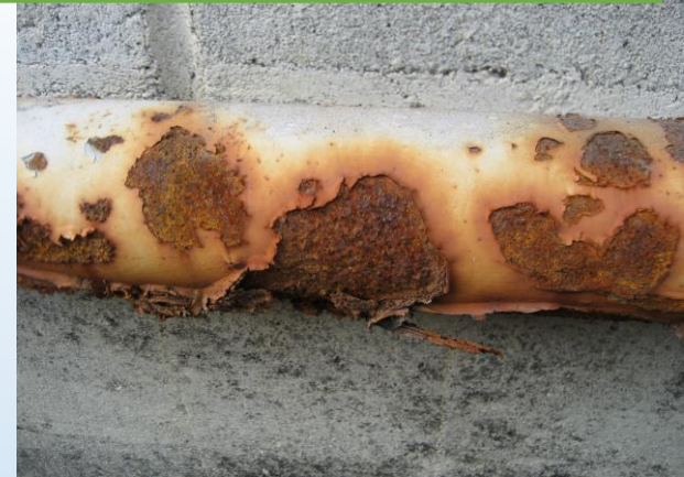
coroziunea sub suprafață
